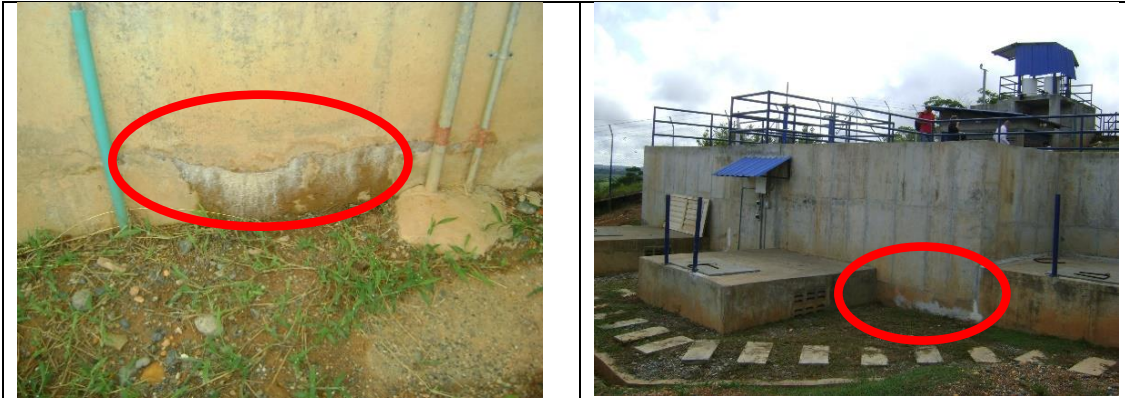
Figuras 1 y 2: Filtraciones en Muros de los tanques de Lodos.
