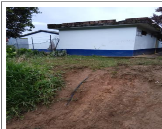
FOTO 17. Detalle de instalación de domiciliaria para Centro Educativo Rural La Sevilla, no se cumplen las profundidades mínimas de diseño. Ubicación. Vereda La Sevilla. Levantó. Angela María Duque Agudelo – Profesional Universitaria. Juan David González Orozco – Profesional Universitario
