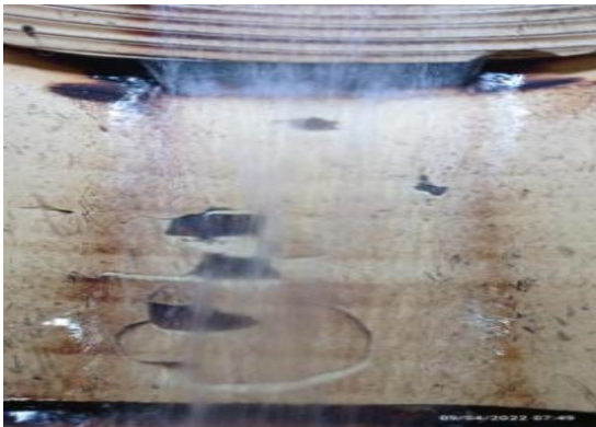
FOTO 05. Deterioro prematuro y daños en la red de Alcantarillado Diam. 42" que fue instalada con recursos contrato Soporte entregado por las Empresas Públicas de Jericó Levantó. Ángela María Duque Agudelo y Juan David González Orozco – Profesionales Universitarios
