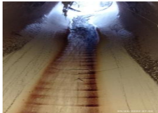
FOTO 06. Deterioro prematuro y daños en la red de Alcantarillado Diam. 42" que fue instalada con recursos contrato Soporte entregado por las Empresas Públicas de Jericó Levantó. Ángela María Duque Agudelo y Juan David González Orozco – Profesionales Universitarios
