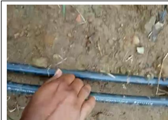
FOTO 15. Tubería o manguera para la instalación de dos domiciliarias, no se cumplen las profundidades mínimas de diseño. Ubicación. Viviendas de la vereda La Sevilla. Levantó. Angela María Duque Agudelo – Profesional Universitaria. Juan David González Orozco – Profesional Universitario
