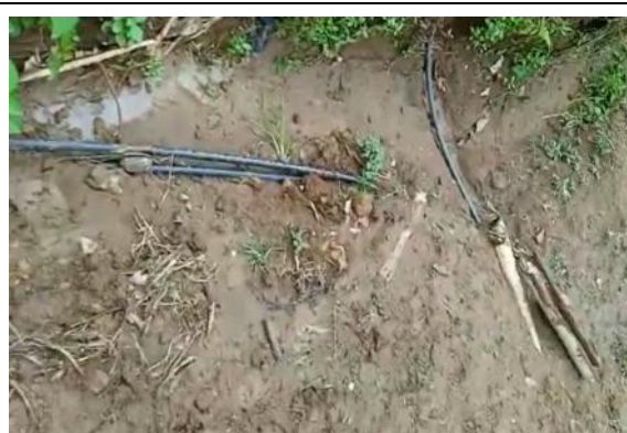
FOTO 16. Tubería o manguera para la instalación de domiciliarias, no se cumplen las profundidades mínimas de diseño. Ubicación. Camino de herradura en la vereda La Sevilla. Levantó. Angela María Duque Agudelo – Profesional Universitaria. Juan David González Orozco – Profesional Universitario
