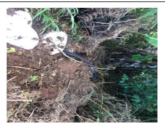
FOTO 18. Detalle de instalación de domiciliaria para viviendas rurales, no se cumplen las profundidades mínimas de diseño. Ubicación. Vereda Sinaí. Levantó. Angela María Duque Agudelo – Profesional Universitaria. Juan David González Orozco – Profesional Universitario
