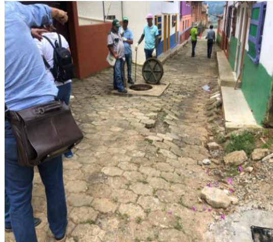
FOTO 08. Deficientes procesos de reinstalación del pavimento articulado, en el área urbana de Jericó. Levantó. Ángela María Duque Agudelo y Juan David González Orozco – Profesionales Universitarios
